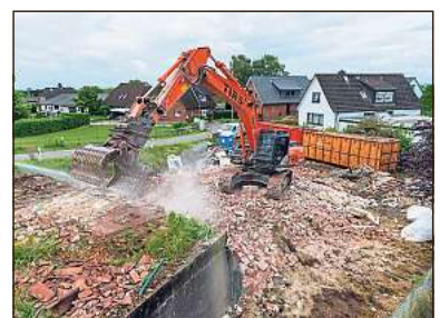
In Deutschland fallen jährlich 215 Millionen Tonnen Bau- und Abbruchabfälle an. Gut aufbereitet, können sie zu einem Teil auch bei der Betonherstellung genutzt werden. Foto: dpa
